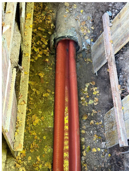
Figura 9 – Dettaglio rimozione liner CIPP collassato
