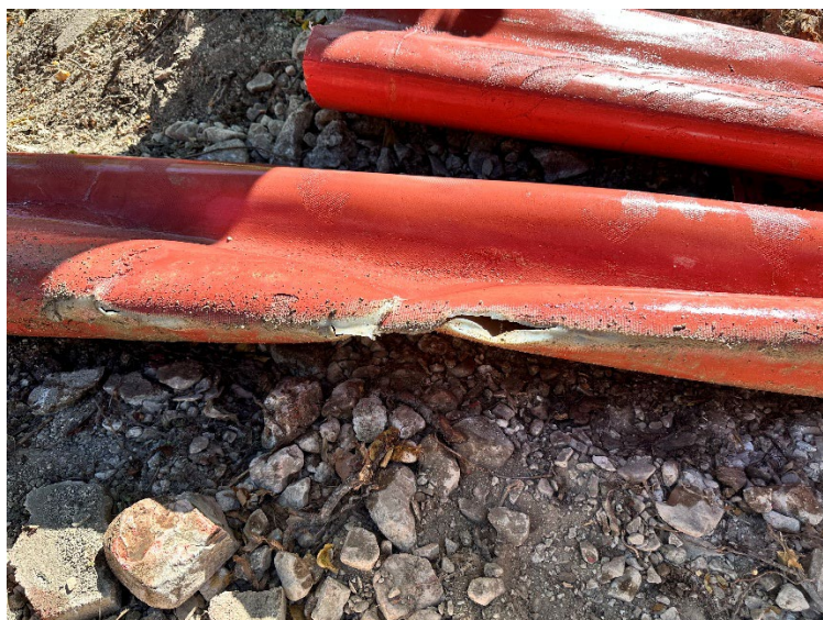
Figura 10 - Dettaglio zone danneggiate del liner CIPP successivamente collassato
