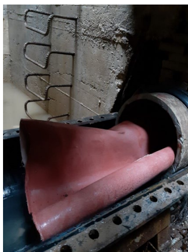
Figura 2: Liner CIPP DN350 collassato
