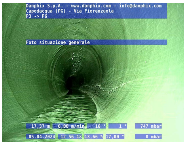
Figura 19 – Ispezione post-catalisi scarico DN500
